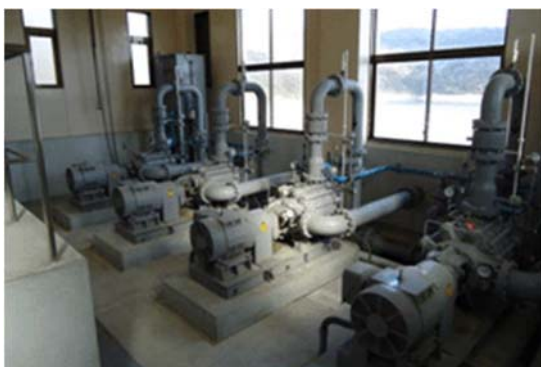
高松揚水機場（ポンプ場）
